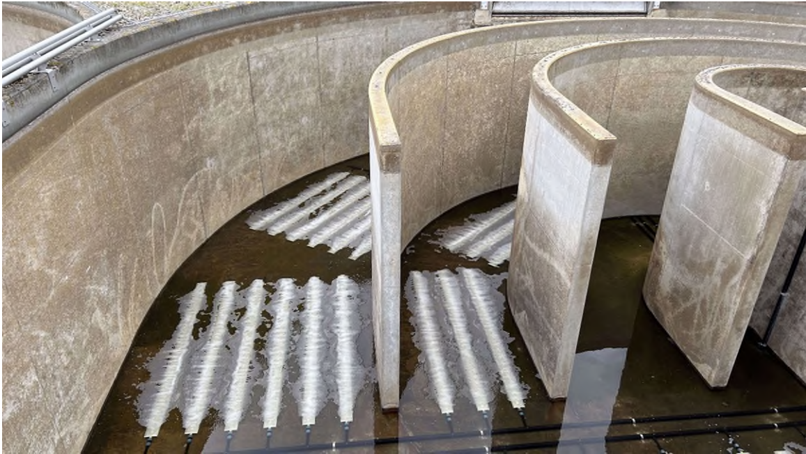
Monteret bundbelufningsudstyr i tank
